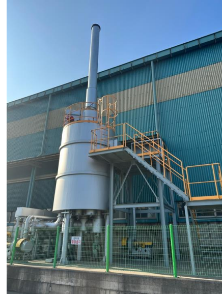
포항공장 RTO 설비
